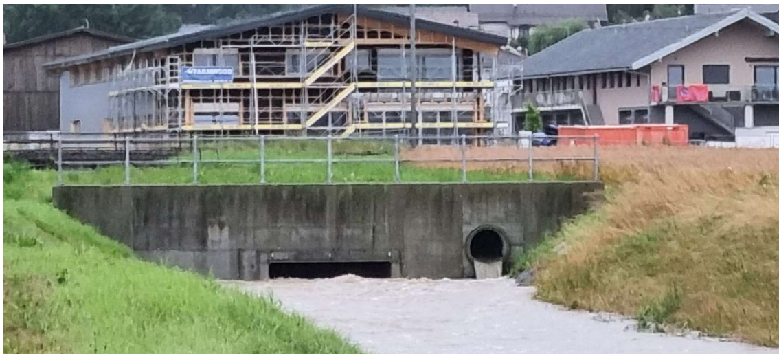
Sortie du canal de dérivation dans la zone de la Planchettaz
