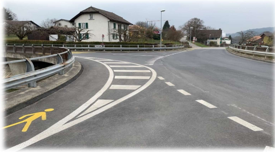
Travaux d'élargissement de la chaussée et pose d'un nouveau tapis bitumineux avec nouveaux marquages routiers (pont sur la RC 601)
